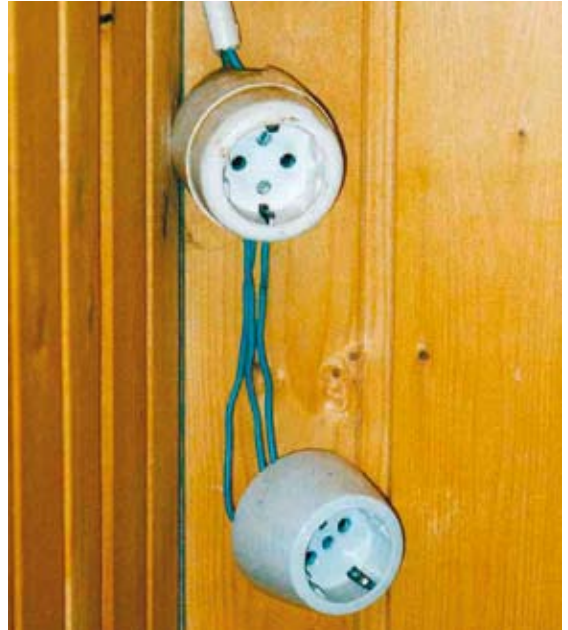
Maallikon tekemä virheellinen sähköasennus...
