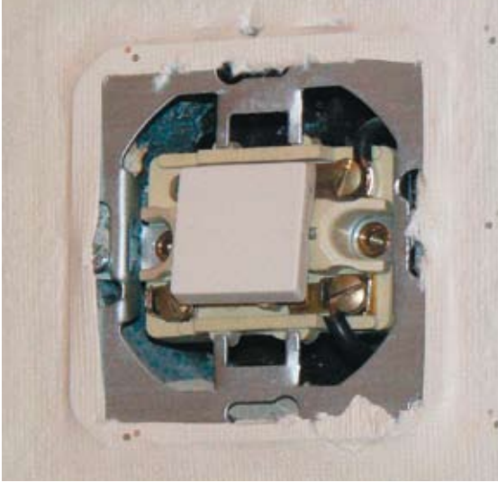
Kytkimen peitelevy puuttuu, jännitteiset liitinruuvit kosketeltavissa. Vaara!
