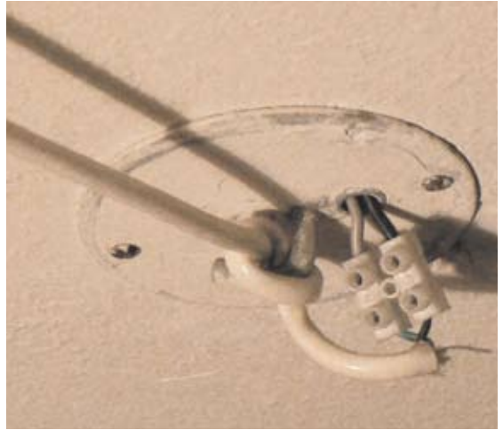
Kattorastian siirtokansi vedonpoistoineen puuttuu.
