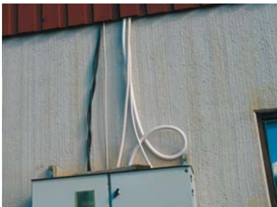
Kaapeleiden kiinnitys on puutteellinen.
