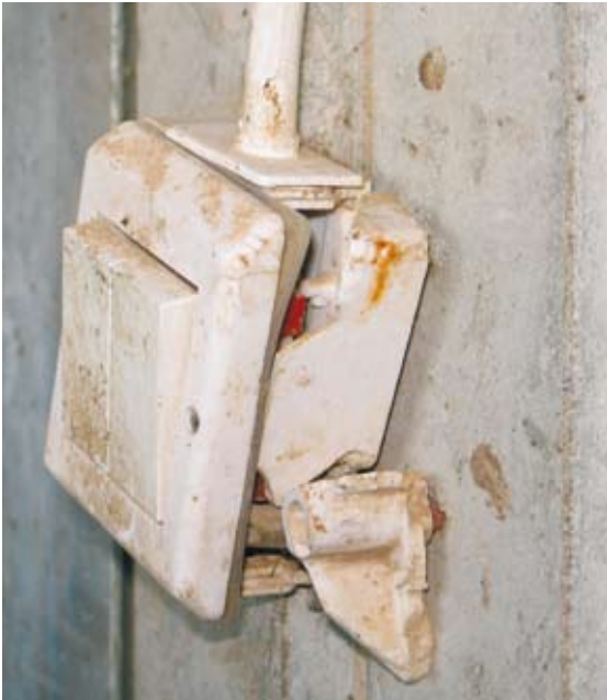
Kytkimen kuori on rikki. Korjauta vika viipymättä!
