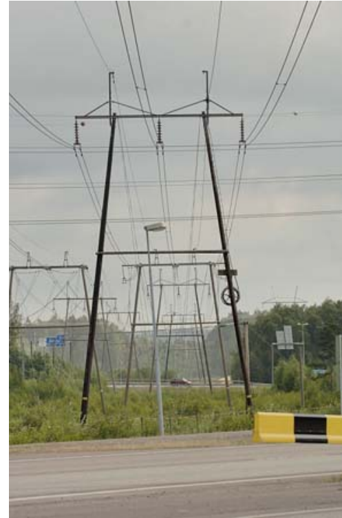
110 000 voltin harustettu pylväs
