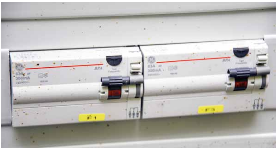
Vikavirtasuojan toiminta tulee testata määrävälein.
